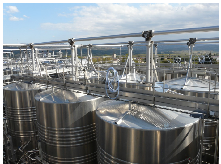
Photo 2 : Cuvée destinée aussi bien aux vinifications qu'à la conservation des vins — Photo ICV
