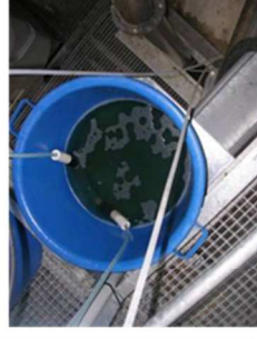
Bac de solution et crépines de pompage
