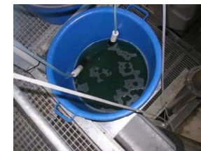
Bac de solution et crépines de pompage
